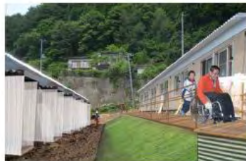
「掃き出し口側にデッキを設置した時のイメージ」： 車いす用出入口、バリアフリー化
